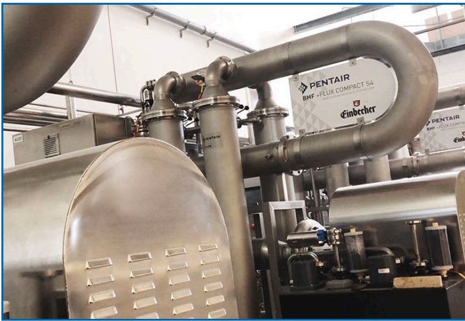
Pentair BMF System bei der Einbecker Brauerei in Deutschland
