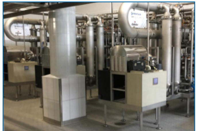
Pentair BMF System bei der Einbecker Brauerei in Deutschland
